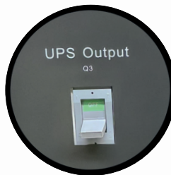
Breaker de salida
