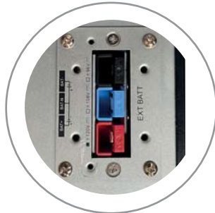
Conector de banco de baterías
